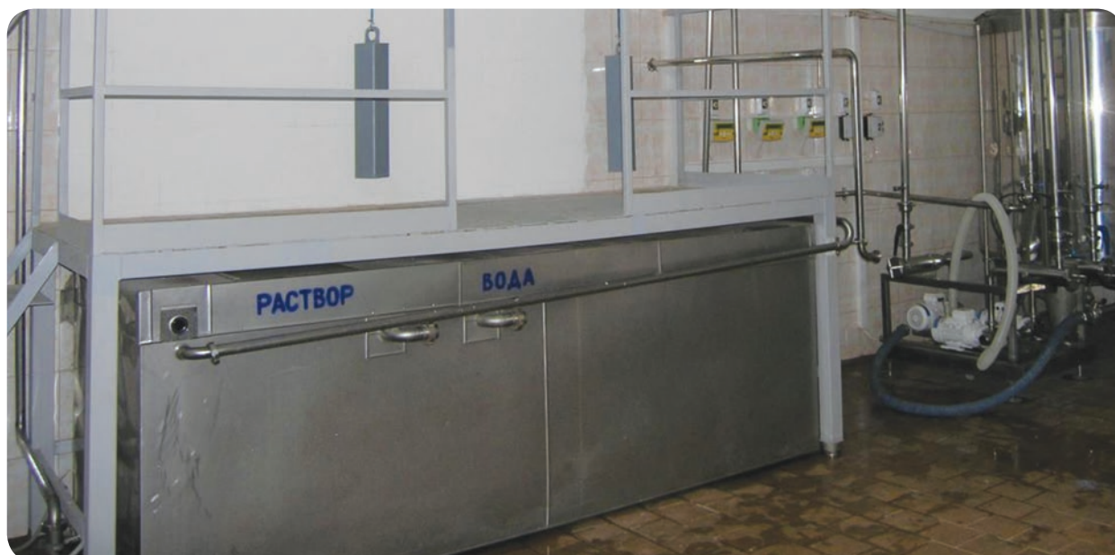
Рис. 5. Бак повторно используемой отепленной воды для ополаскивания автомолцистерн
